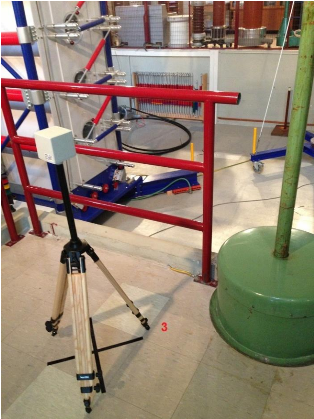
Εικόνα 5.8: Θέση μέτρησης 3 του μαγνητικού πεδίου. Κάτω στο βάθος φαίνεται ο ρευματοφόρος αγωγός.
