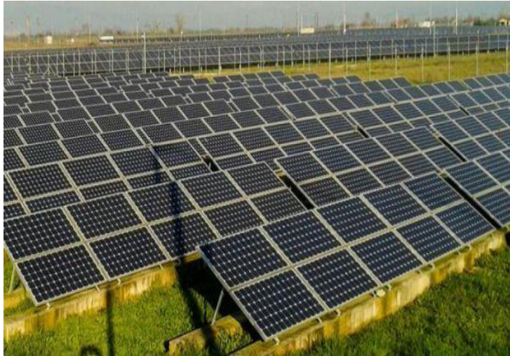
Εικόνα 1.2 Εγκατάσταση φωτοβολταϊκών μεγάλης κλίμακας
