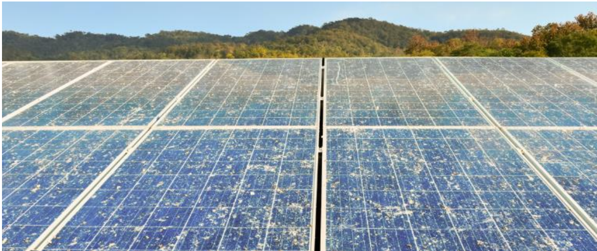
Σχήμα 2-31: Το φαινόμενο του soiling σε φωτοβολταϊκή εγκατάσταση [12].
