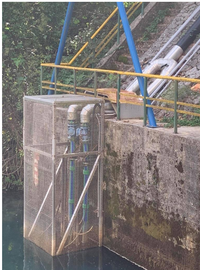
Εικόνα 16: Δίδυμο αντλιών απορροής νερού
