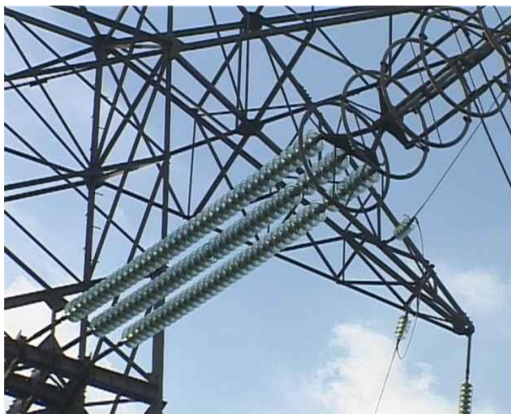
Εικόνα 1.5: Γυάλινοι μονωτήρες αναρτήσεως σε πυλώνα υψηλής τάσης [15].
