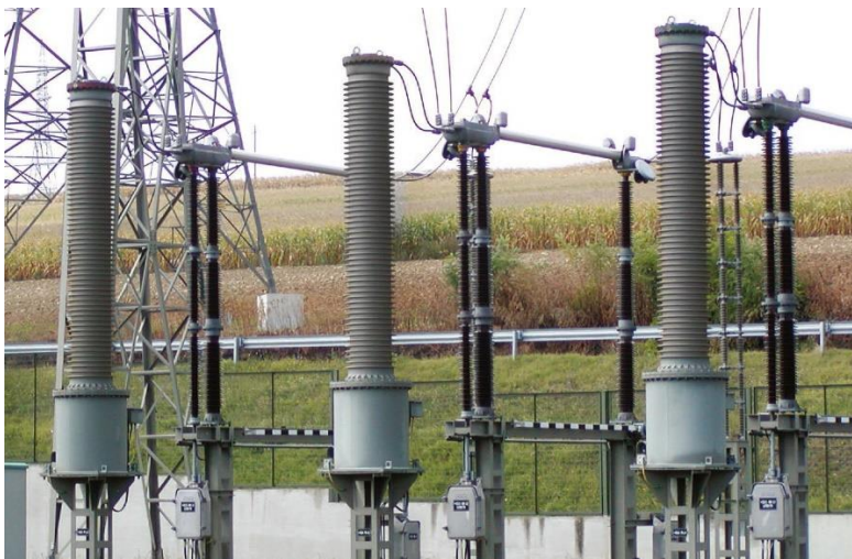
Εικόνα 1.9: Μετασχηματιστές μέτρησης τάσεως SF 6 [21].
