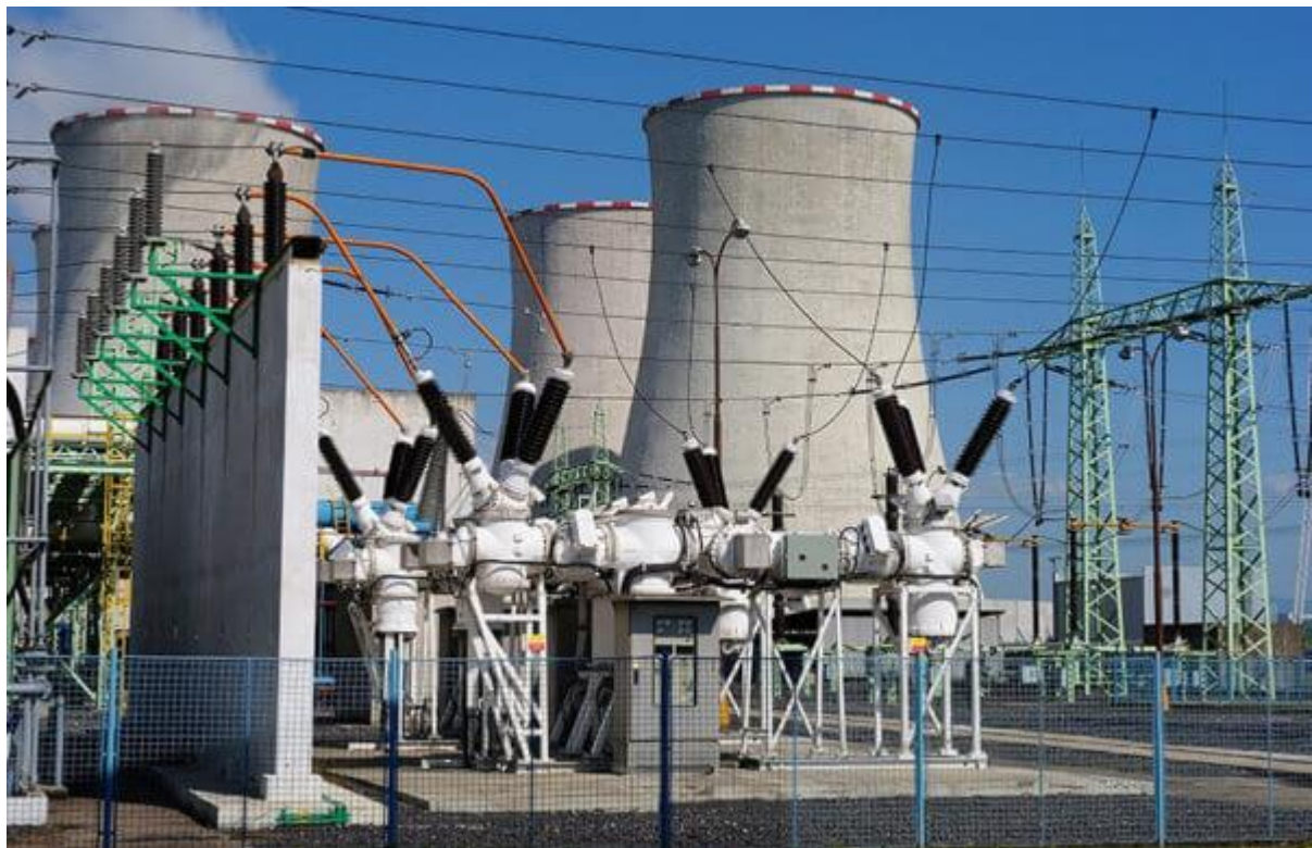
Εικόνα 1.11: Υποσταθμός ανύψωσης θερμοηλεκτρικού σταθμού παραγωγής [25].
