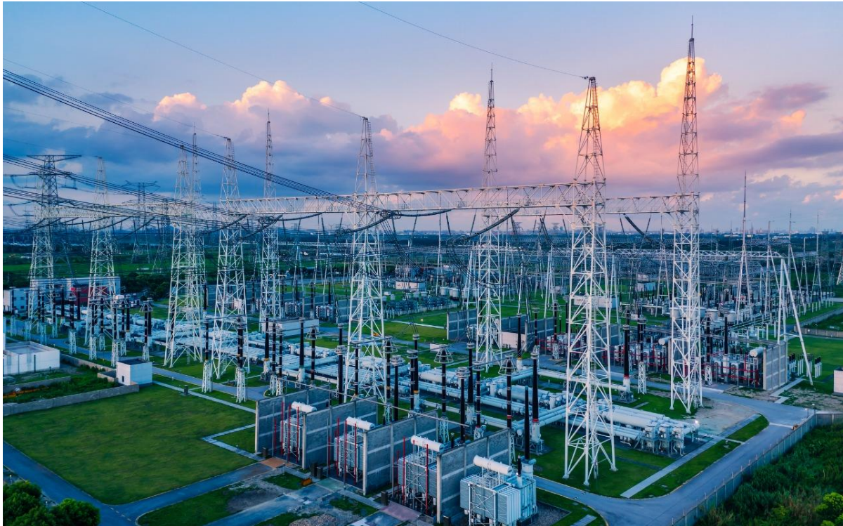
Εικόνα 1.1: Υποσταθμός μεταφοράς ηλεκτρικής ενέργειας [4].
