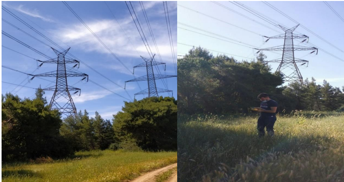
Εικόνα 6.7: Μέτρηση ηλεκτρικού πεδίου στον εγκάρσιο άξονα που απέχει 150 m από το μέσον των Πυλώνων ΑΡΚ 59 και ΚΛΣ 54.
