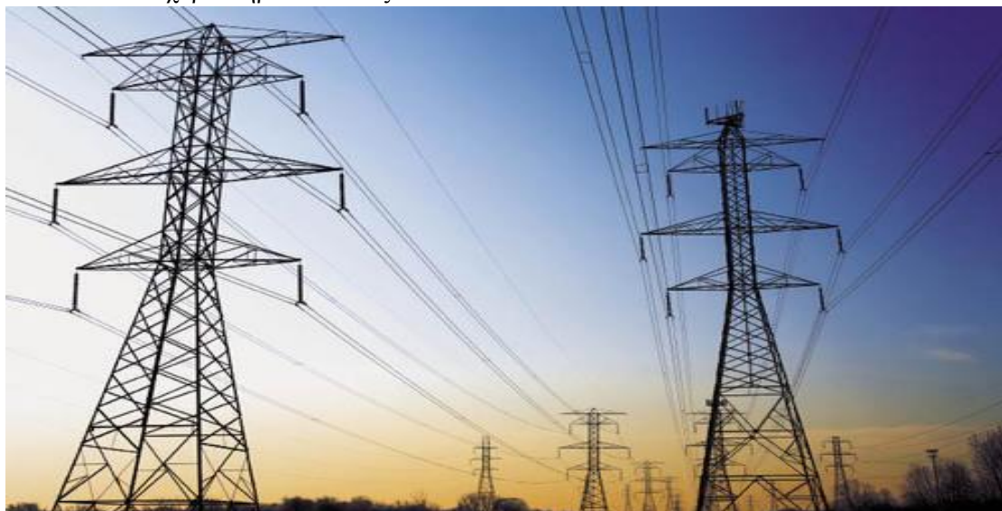
Εικόνα 1.2: Εναέριες Γραμμές Μεταφοράς Ηλεκτρικής Ενέργειας [13].
