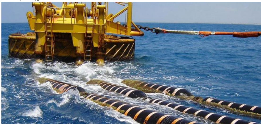
Εικόνα 1.3: Υπόγειες Γραμμές Μεταφοράς Ηλεκτρικής Ενέργειας [14].
