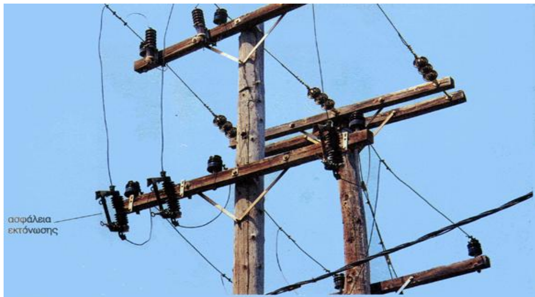
Εικόνα 21 Ασφαλειοαποζεύκτες μέσης τάσης. [19]
