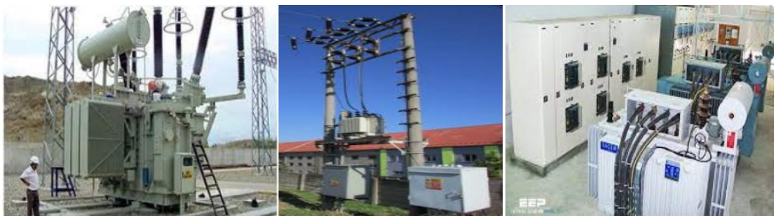
Εικόνα 14 Υποσταθμοί ΜΣ/ΧΤ (α) επίγειος (β) εναέριος (γ) υπόγειος.[31]
