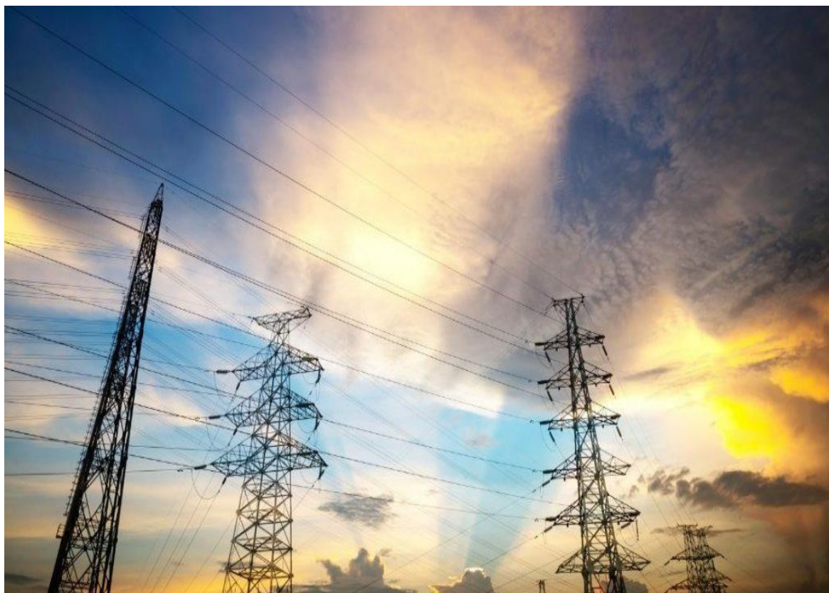
Εικόνα 9 Γραμμές μεταφοράς ρεύματος
