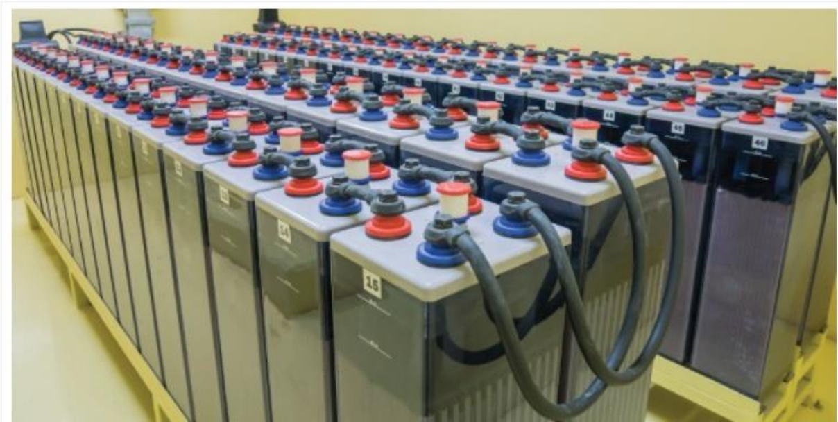
Εικόνα 27: Παράδειγμα εγκατάστασης μπαταριών μολύβδου οξέος (Πηγή: Rising renewable energy installations inflate the demand for stationary lead acid batteries market, 2021)
