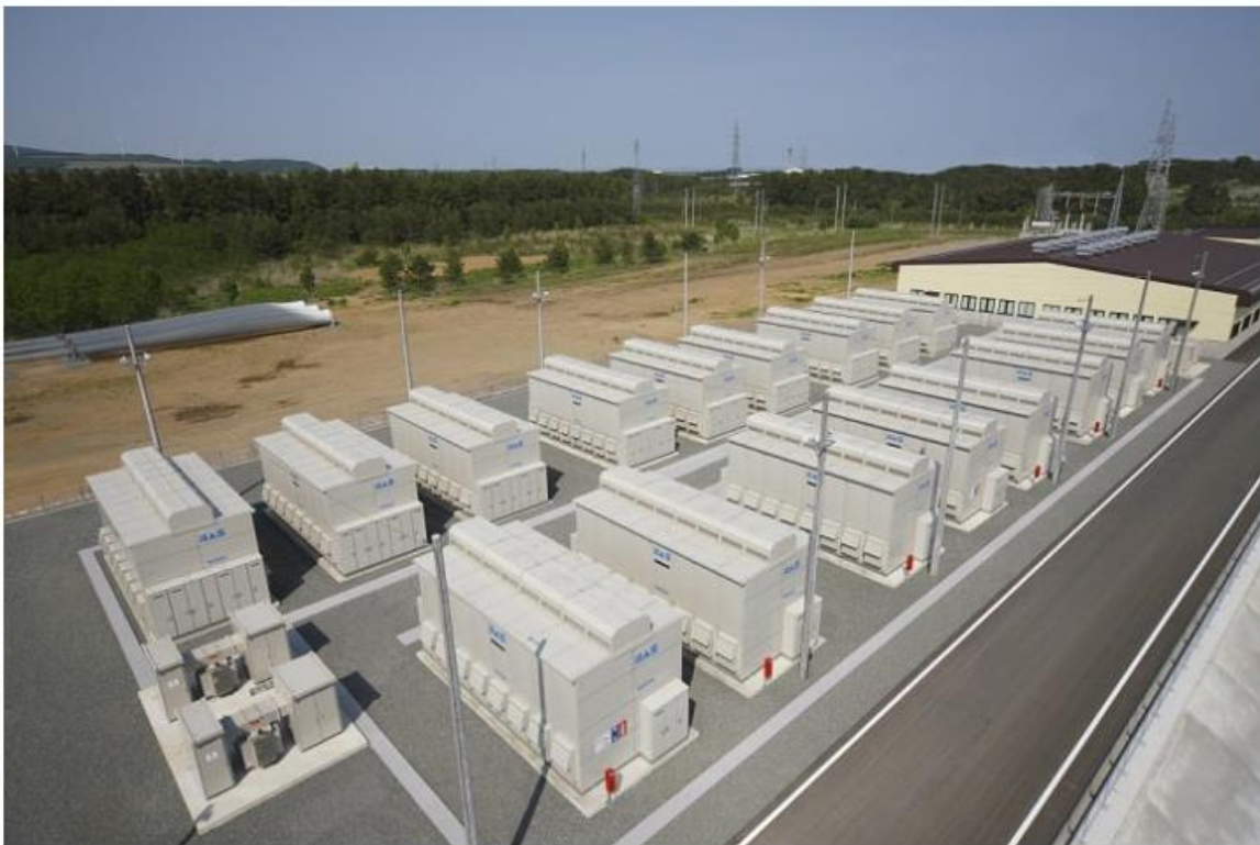
Εικόνα 29: Παράδειγμα εγκατάστασης μπαταριών θείου νατρίου (Πηγή: Parnell, 2017)
