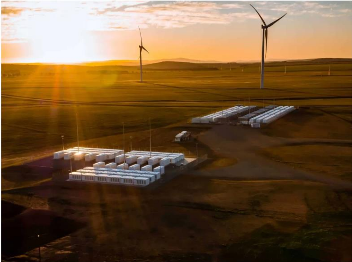
Εικόνα 24: Σταθμός Hornsdale Power Reserve της Tesla στην Αυστραλία (πηγή: Alvarez, 2018)
