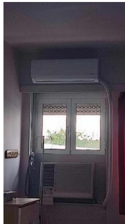
Σχήματα 6.17: Κλιματιστικό split inverter καινούργιο μαζί με κλιματιστικό παραθύρου που δεν λειτουργεί
