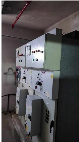
Σχήμα 3.1: Πίνακας μέσης τάσης Μεταξά [3]
