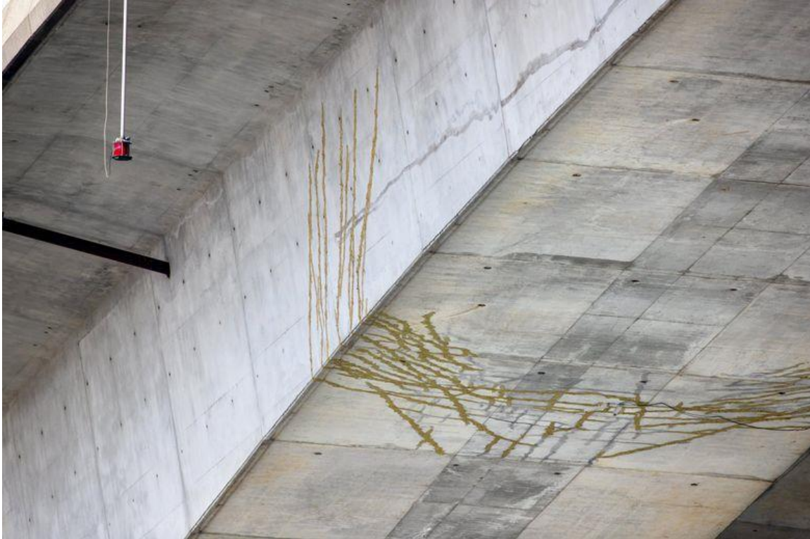
Σχήμα 1: Παράδειγμα Ρωγμών στην γέφυρα West Seattle Bridge στην Ουάσινγκτον στις Ηνωμένες Πολιτείες της Αμερικής [3]
