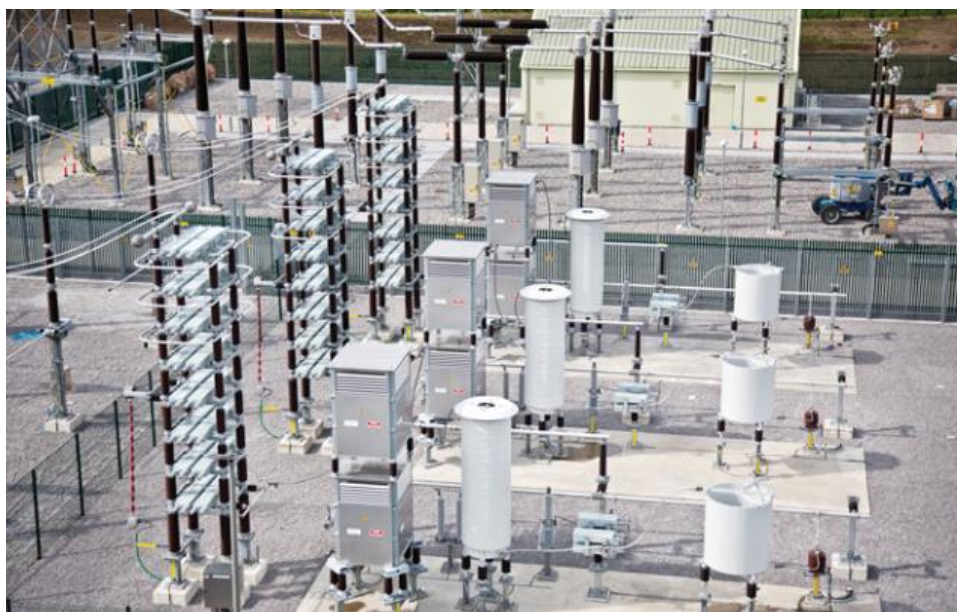
Εικόνα 3.4: AC φίλτρο στο σύστημα HVDC-Light της AB. [ABB]
