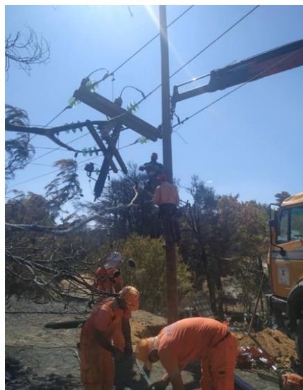
Εικόνα 1.11: Καταστροφή στύλου Μέσης Τάσης – Πυρκαγιές, καλοκαίρι 2021.
