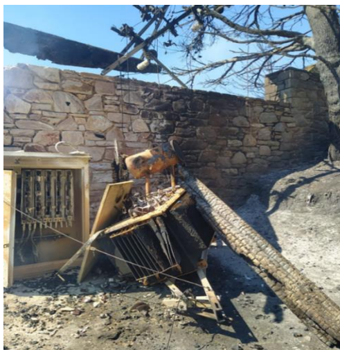
Εικόνα 1.14: Καταστροφή εναερίου Υ/Σ.
