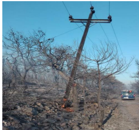
Εικόνα 1.13: Καταστροφή εναερίου Δικτύου Μ.Τ.
