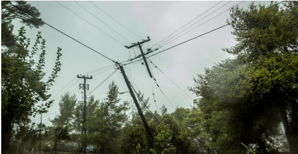
Εικόνα 1.8: Καταστροφή στο σύστημα ηλεκτροδότησης, κακοκαιρία “Ιανός” [29].
