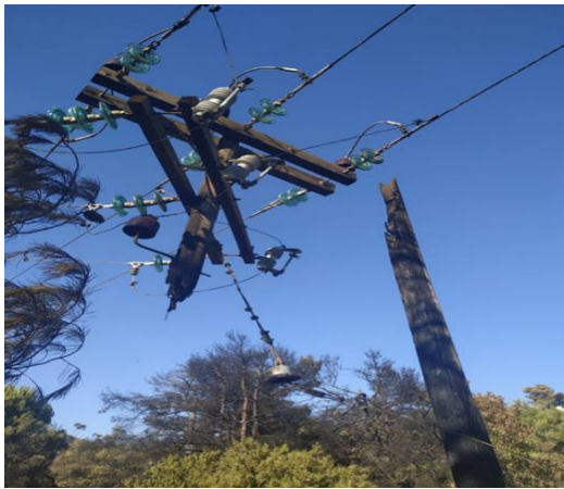
Εικόνα 1.12: Καταστροφή εναερίου Δικτύου Μ.Τ.
