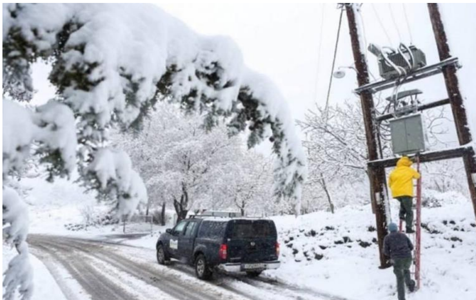
Εικόνα 1.9: Αποκατάσταση από τεχνικό συνεργείο ΔΕΔΔΗΕ σε εξοπλισμό του εναερίου Δικτύου, κακοκαιρία «Μήδεια».
