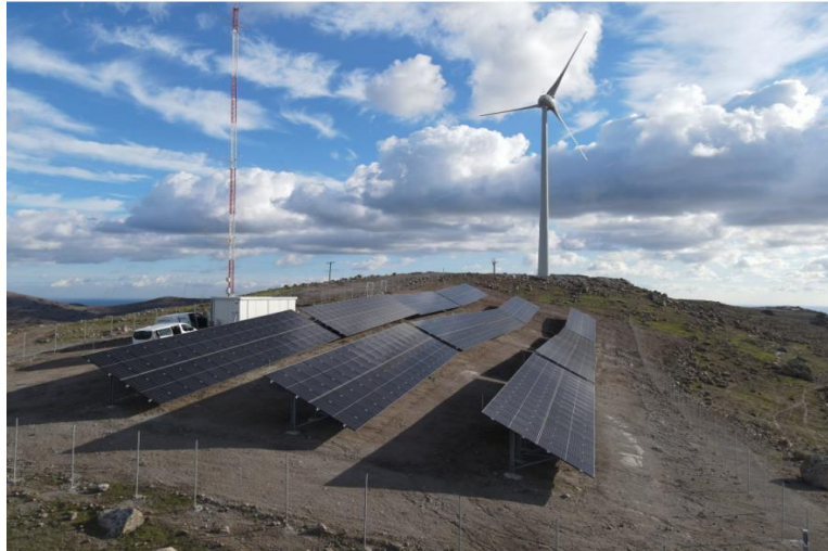
Εικόνα 2.26: Ο Υβριδικός σταθμός στο νησί του Αγίου Ευστρατίου [73].
