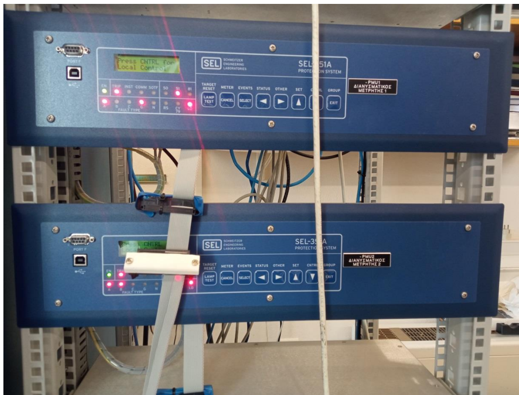
Εικόνα 2.11: Ψηφιακοί ηλεκτρονόμοι SEL-351A
