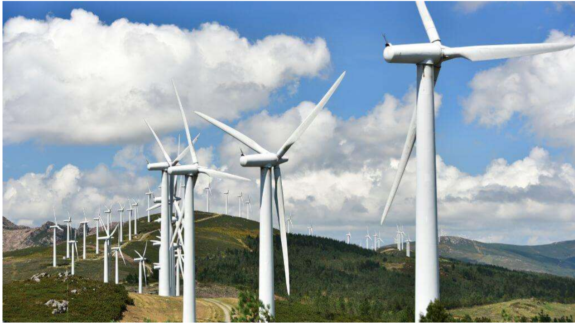
Εικόνα 3.Χερσαίο Αιολικό Πάρκο
