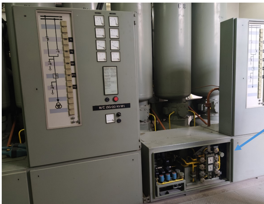
Εικόνα 6.3 Χώρος μανομέτρων και βαλβίδων πίεσης
