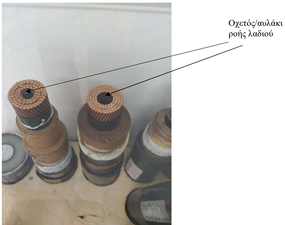
Εικόνα 3.7 Οχετός καλωδίων λαδιού-χαρτιού
