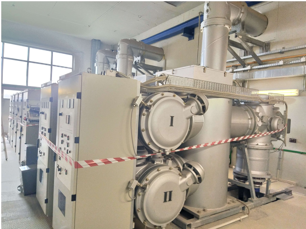
Εικόνα 5.1 Σήμανση με κόκκινη κορδέλα σε εξοπλισμό υπό τάση
