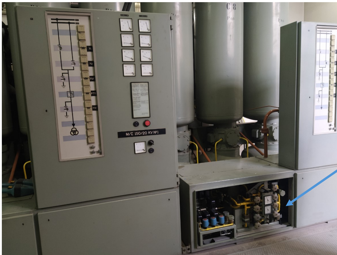
Εικόνες 5.3 Ανοιχτό κάτω μέρος πίνακα ελέγχου
