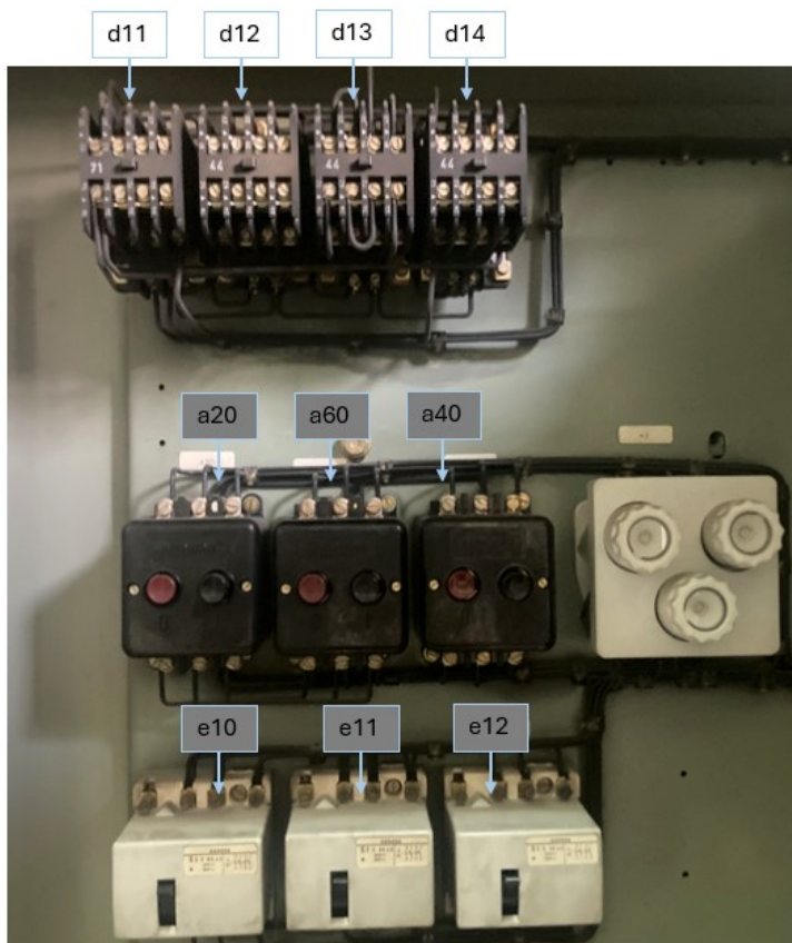
Εικόνα 5.12 Alarm εξαναγκασμένης πτώσης, διακόπτες και ασφάλειες
