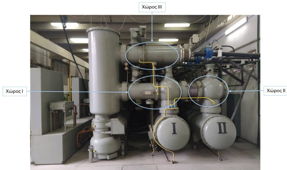
Εικόνα 5.6 Χώροι I, II και III αερίου SF 6
