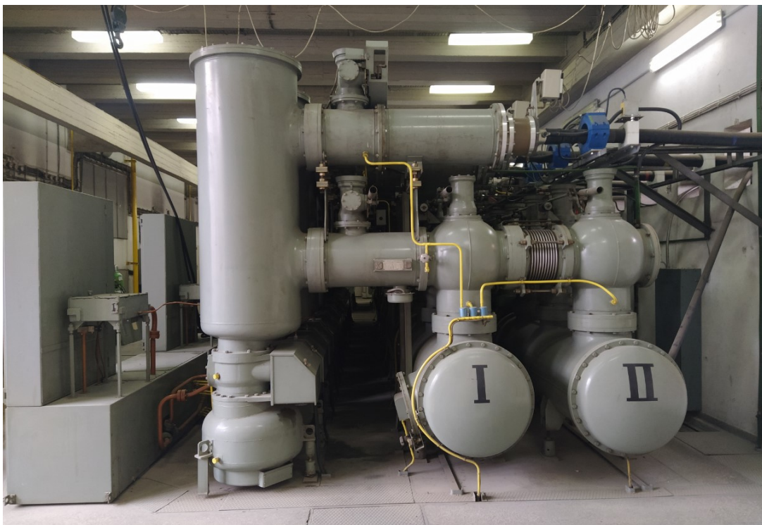
Εικόνα 6.2 Χώρος GIS 150kV
