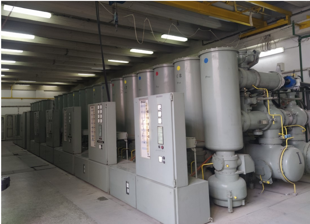
Εικόνα 6.1 Χώρος GIS 150kV
