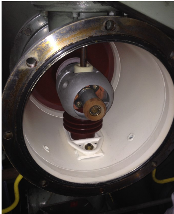
Εικόνα 3.4 Ακροκιβώτιο GIS 150kV
