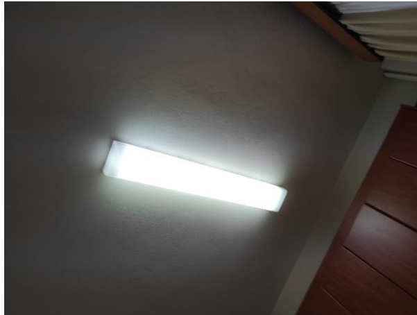
Εικόνα 43 Γραμμικό φωτιστικό οροφής, φθορισμού T8 με 36W.
