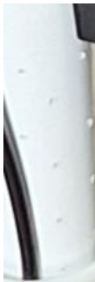
Σχήμα 2.27: Μικρές οπές για μέτρηση συγκέντρωσης CO 2 από τον αισθητήρα εσωτερικά.
