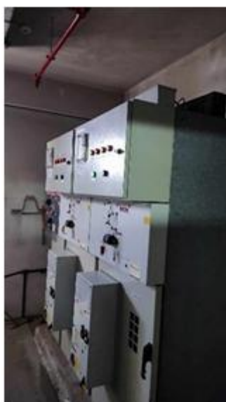
Σχήμα 3.1 Πίνακας μέσης τάσης Θριασίου[3]
