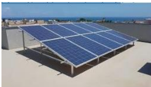
Σχήμα 7.1: Φωτοβολταϊκά τοποθετημένα σε ταράτσα οικίας [29]
