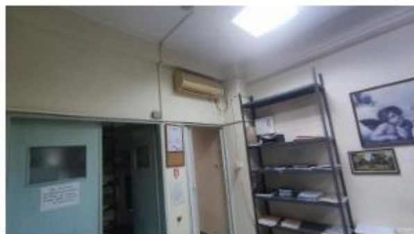
Σχήματα 6.16: Παλιό κλιματιστικό split του νοσοκομείου [36]
