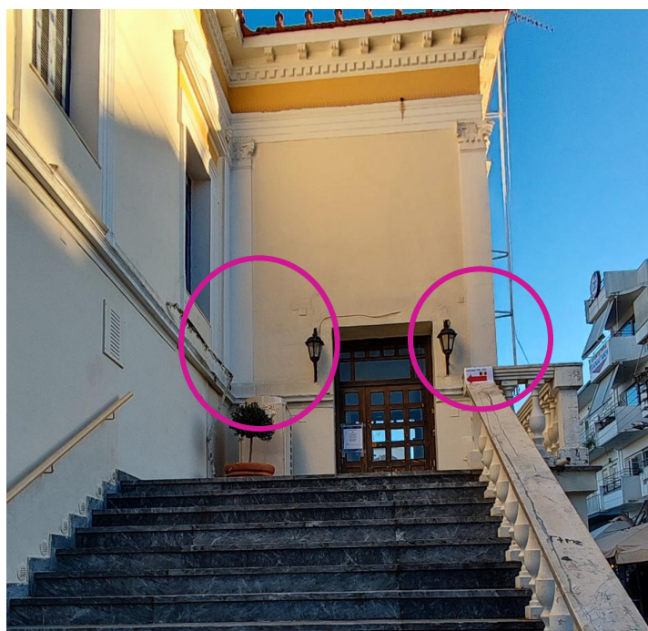
Εικόνα 93: Φωτογραφία που ελήφθη το 2025 κατά τον επιτόπιο έλεγχο. Η υφιστάμενη κατάσταση περιλαμβάνει 2 απλίκες εκατέρωθεν της πόρτας εισόδου, ενώ δεν περιλαμβάνει επίτοιχα φωτιστικά ανάδειξης των παραστάδων. Τα σημεία κυκλώνονται με χρώμα ματζέντα.
