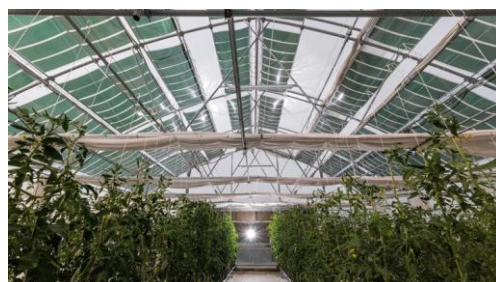
(β) Φωτοβολταϊκά σε οροφή θερμοκηπίου
