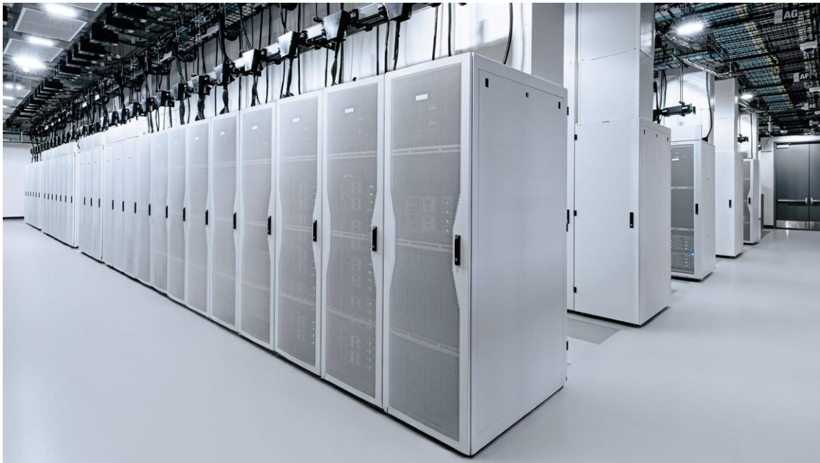
Εικόνα 1-2: Αίθουσα κέντρου δεδομένων με συστοιχίες racks.
