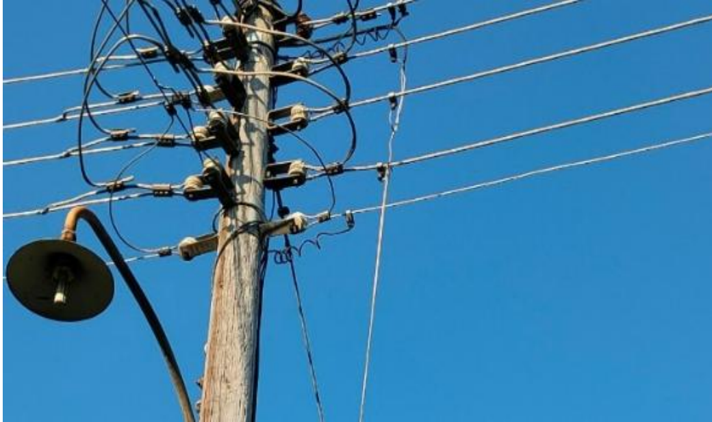
Εικόνα 3.23 Απευθείας ρευματοληψία από Δίκτυο Χαμηλής Τάσης [34]
