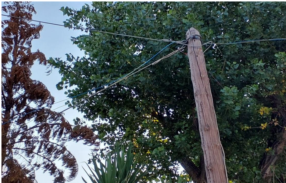
Εικόνα 3.24 Απευθείας ρευματοληψία από Δίκτυο Χαμηλής Τάσης [34]
