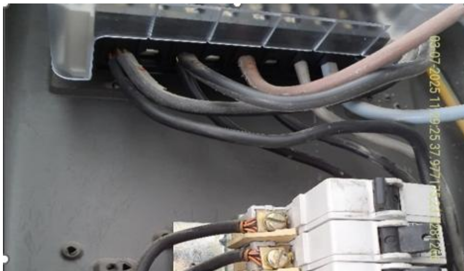
Εικόνα 3.15 Βραχυκυκλωμένοι ακροδέκτες μετρητή [34]
