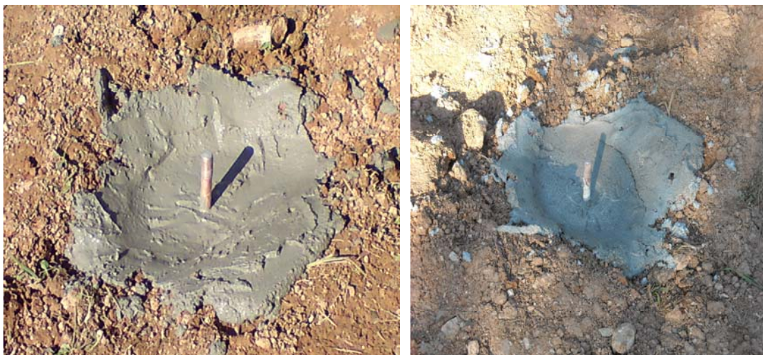
Εικόνα 5.6: Ηλεκτρόδια γείωσης εμβαπτισμένα σε μπετονίτη και σκυρόδεμα.
