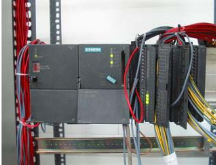
Σχήμα Α.5 το PLC που χρησιμοποιήθηκε στο εργαστήριο.
