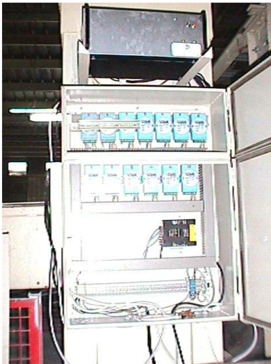
Σχ. 27 Ο κύριος ηλεκτρικός πίνακας συγκέντρωσης των σημάτων των ασητηρών που περιέχει και τα συστήματα δειγματοληψίας (Data Logging)
