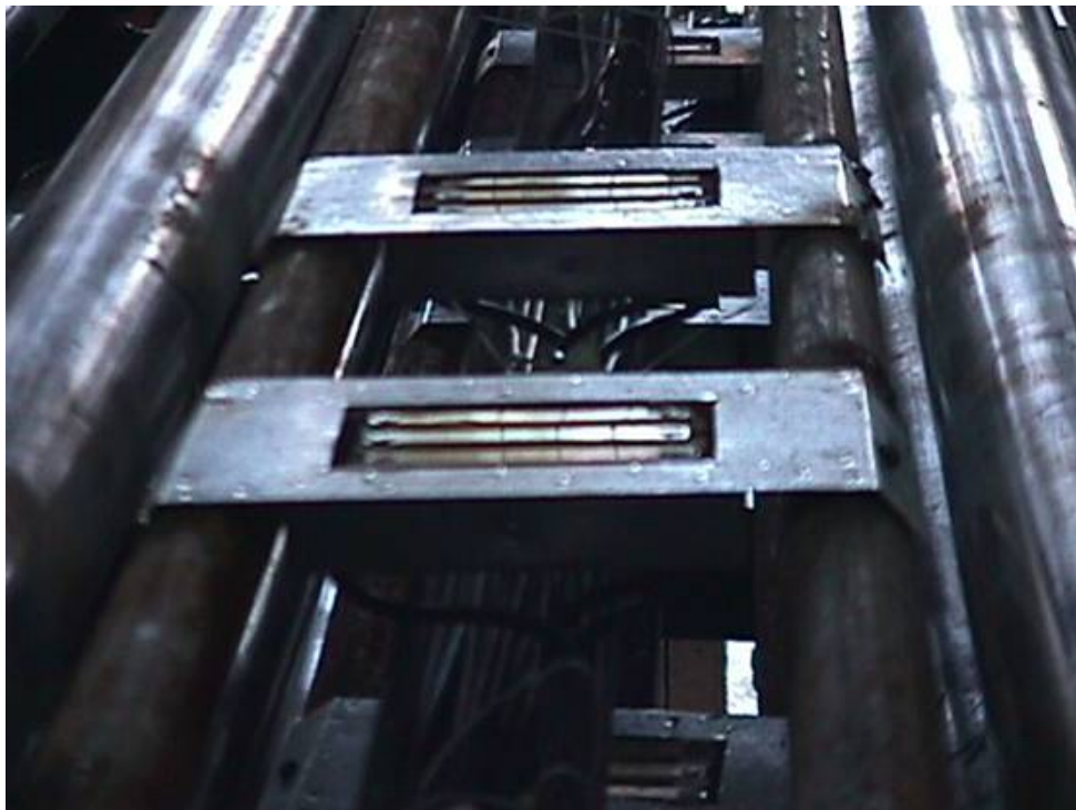
Σχ. 23 Τοποθέτηση των αισθητήρων ανάμεσα από ράουλα κοντά στην έξοδο του φούρνου αφύγρανσης
