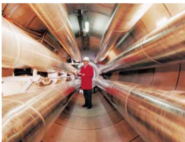
Σχήμα I-2.3: GIL που περιέχουν μείγμα SF 6 /N 2 , εντός σήραγγας (Γερμανία). [2]
