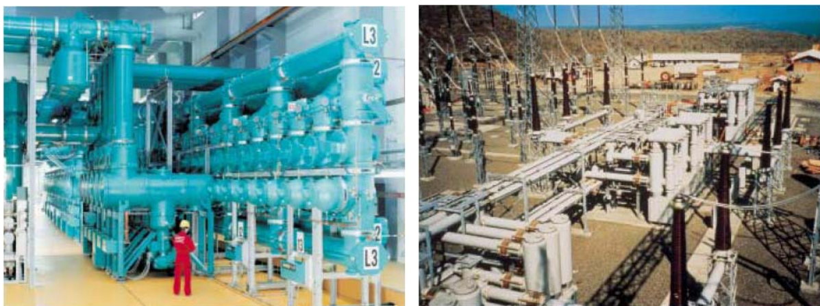
Σχήμα I-2.2: Υποσταθμοί GIS Υψηλής Τάσης. Αριστερά: υποσταθμός κλειστού χώρου 550kV (Γερμανία), δεξιά: υποσταθμός ανοικτού χώρου 500kV (Γαλλία). [2]
