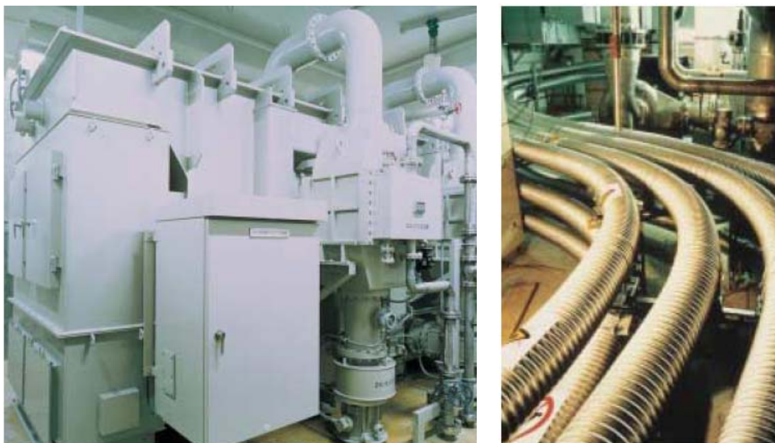
Σχήμα I-2.4: Ηλεκτρικός εξοπλισμός με μόνωση SF 6 . Αριστερά: μετασχηματιστής 23-107 kV (Ιαπωνία), δεξιά: καλώδια YT σε εργοστάσιο πυρηνικής σύντηξης (Γερμανία). [2]
