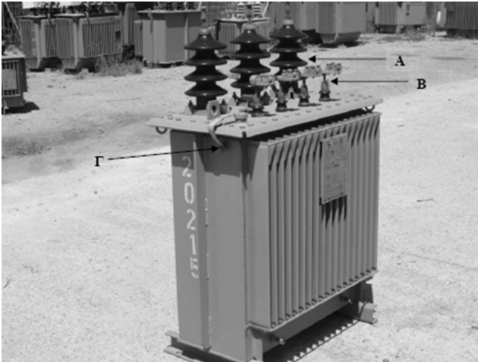
Φωτογραφία III-1. Ένας μετασχηματιστής διανομής ονομαστικής ισχύος P_N = 100 KVA (αριθμός ΔΕΗ: N-20215). A: Ακροδέκτες μέσης τάσεως, B: Ακροδέκτες χαμηλής τάσεως, Γ: Δοχείο (ηλεκτρική γη).
