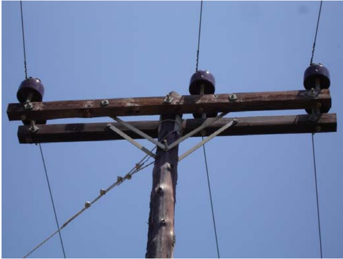
Σχήμα 1.1.1-2: Πίνακας ξύλινου στύλου με ξύλινη τραβέρσα, με μονωτήρες για τη στήριξη των γυμνών αγωγών μίας γραμμής μέσης τάσης. Στην εικόνα φαίνεται και η πρόσδεση του επιτόνου στο στύλο.
