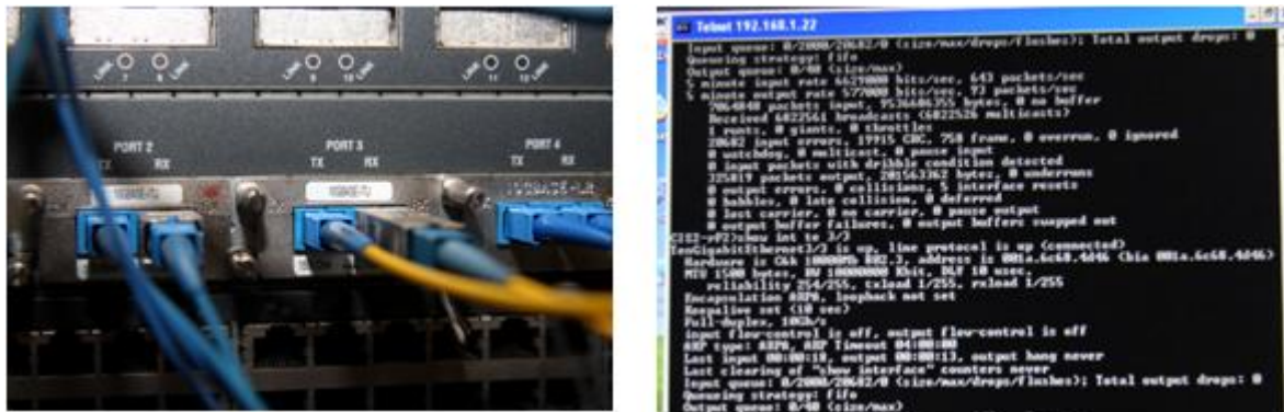
Σχήμα 71: Ηλεκτρονικός δρομολογητής με 10Gb/s οπτικές διεπαφές (αριστερά), Λογισμικό απεικόνισης της ποιότητας των μεταδιδόμενων σημάτων (δεξιά)
