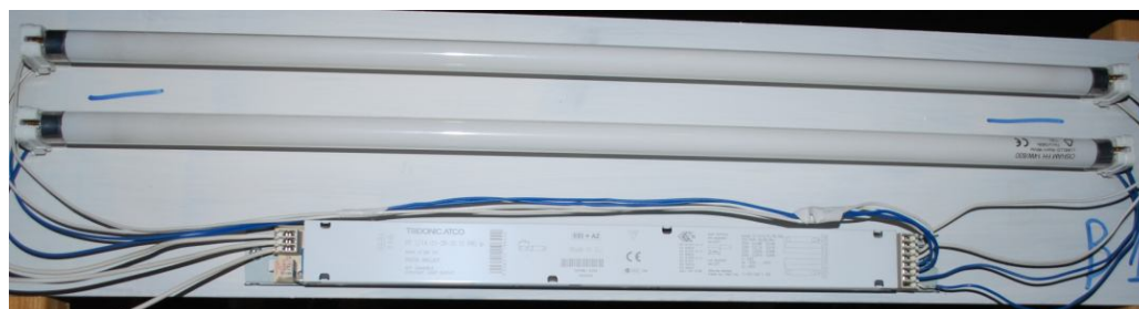
Σχήμα 3.6. Λαμπτήρες της εταιρίας Osram και ballast της εταιρίας Tridonic (α/α 6 στον πίνακα 3.2)
