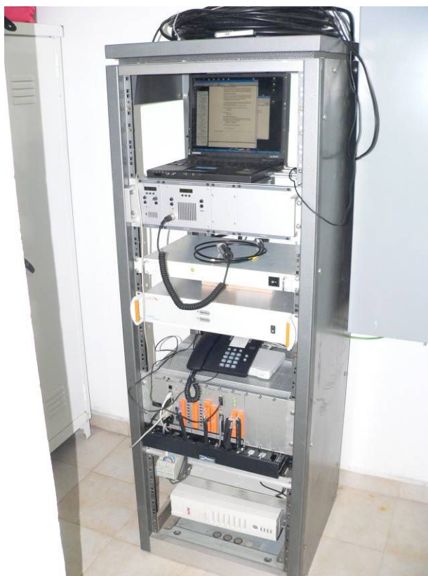
Εικόνα 20. Το rack του εξοπλισμού του ελικοδρομίου – Φαίνονται ο δορυφορικός σταθμός, ο πομποδέκτης αεροναντιλίας, ο μετατροπέας RoIP/VoIP και το UPS
