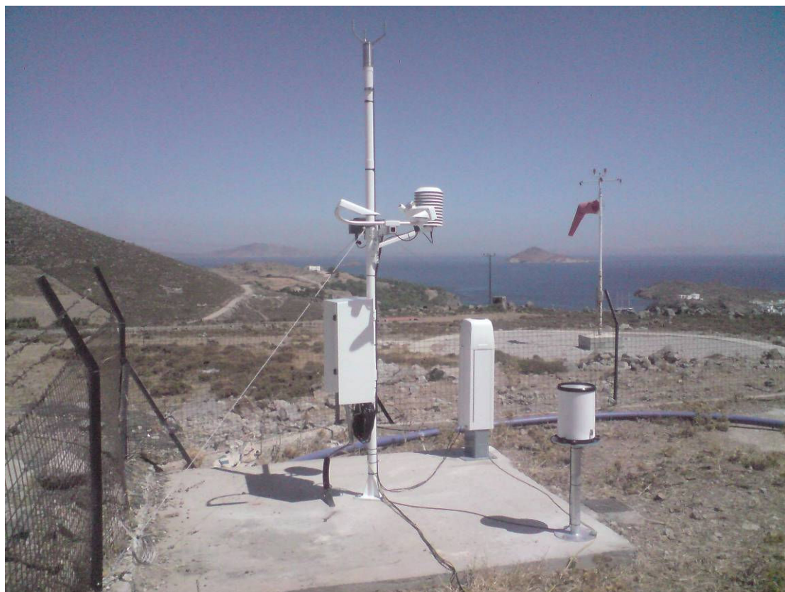
Εικόνα 21. Ο μετεωρολογικός σταθμός AWS520 της εταιρίας Vaisala
