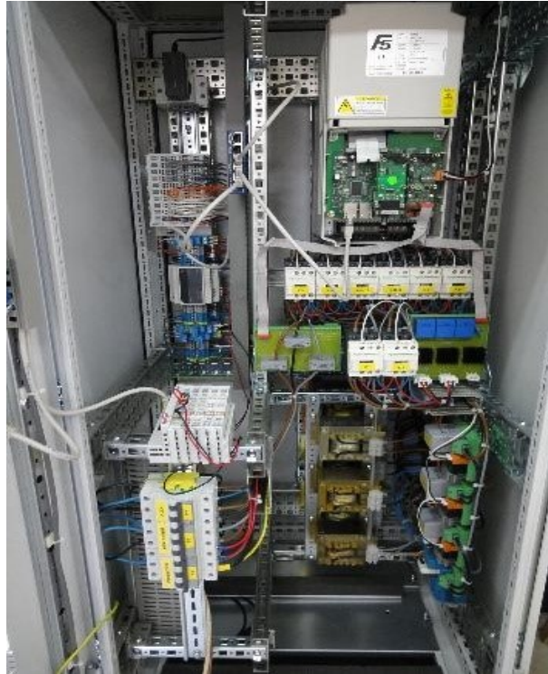
Σχήμα 4.6. Το εσωτερικό του μετατροπέα της διεπαφής ισχύος
